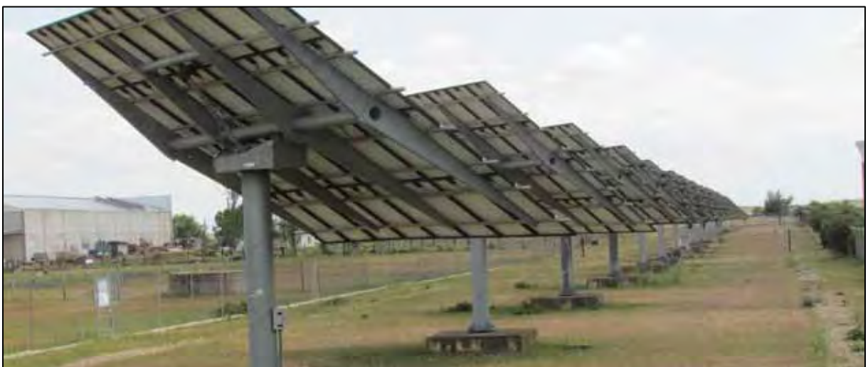
Figura 61. Instalación fotovoltaica de autoconsumo, mayo 2023.
